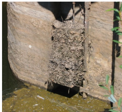
Figure 55 : Grille de protection de la prise d'eau du débit d'attrait d'un ascenseur à poissons colmatée
