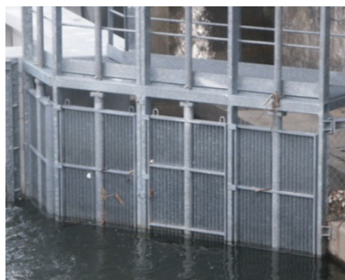
Figure 15 : Grilles d'injection de débit d'attrait pivotantes autonettoyantes
