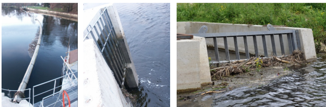
Figure 11 : Protections de la prise d'eau de dispositifs de franchissement : drome flottante à gauche, grille mise hors d'eau au centre et grille en eau à droite (Source de la photo de gauche : A. Lemoine (ONEMA))
