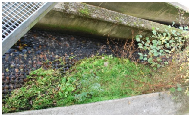
Figure 42 : Développement végétal important recouvrant le substrat d'une passe à anguille
