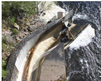
Figure 61 : Glissière de dévalaison endommagée
