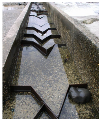
Figure 36 : Passe avec des ralentisseurs dégradés
