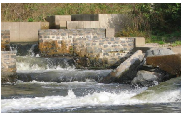
Figure 47 : Prébarrage dont un muret est écroulé
