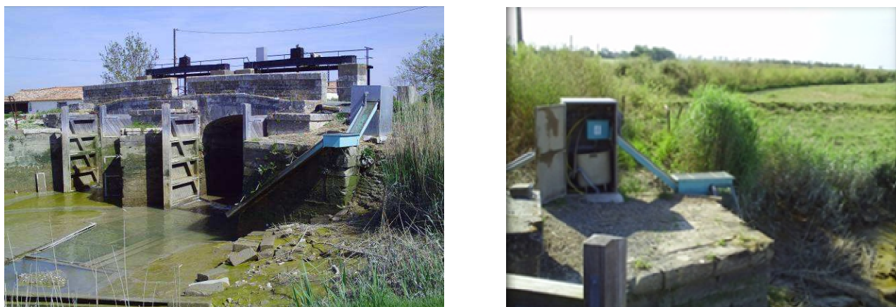
Fig. 22 : Photo du barrage des Portes des Cinq Abbés et de la passe à anguille
