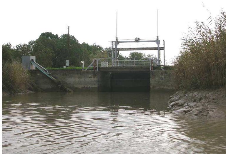
Fig. 26 : photo du barrage des Portes du Contreboth de Vix et sa passe à anguille
