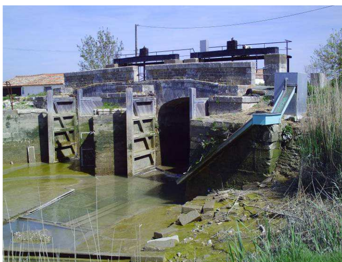
Fig. 2 : Passe à anguille des Portes des Cinq Abbés
