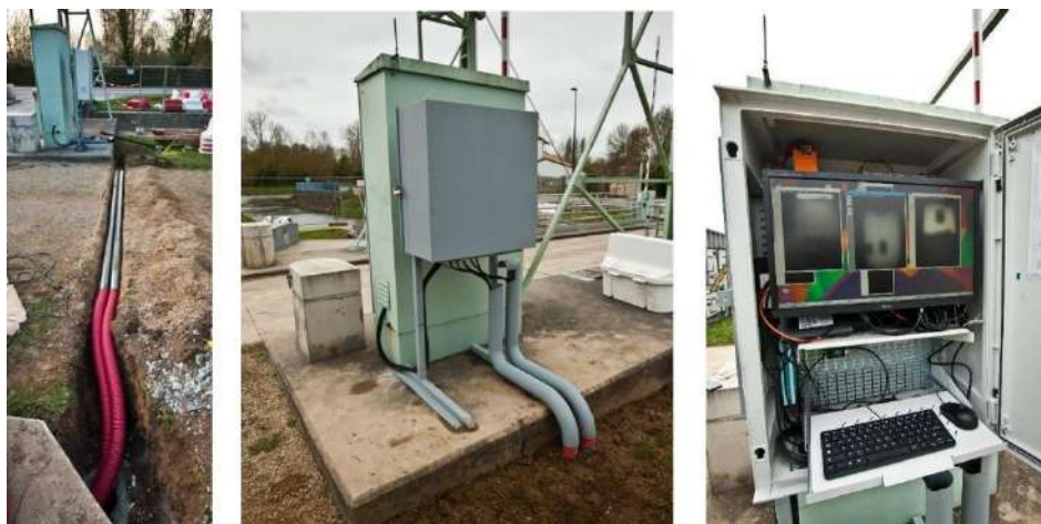
Figure 4 : Armoire technique intégrant les alimentations électriques et l'ordinateur d'acquisition
