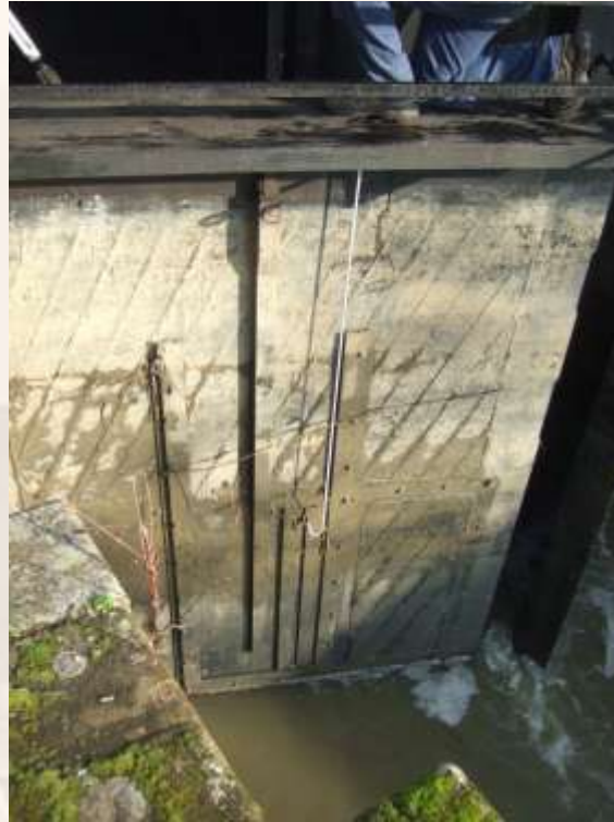
Ouverture manuelle via la passerelle
