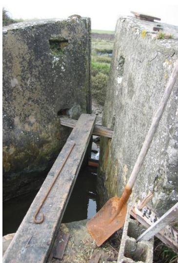
Batardeau posé dans une essalle dans le Marais Talmondais (Photo : A. Baisez LOGRAMI)
