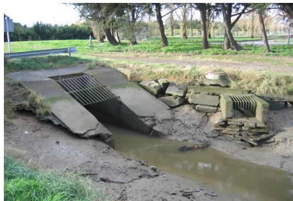
Buse en prise d'un étier en Loire estuaire (Photo A. Baisez LOGRAMI)
