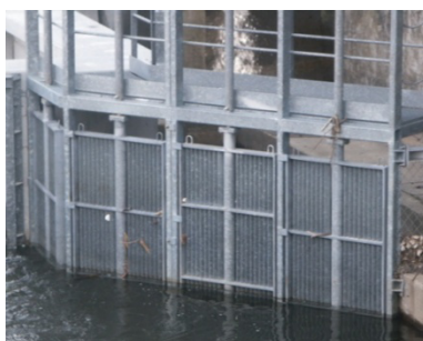
Figure 15 : Grilles d'injection de débit d'attrait pivotantes autonettoyantes
