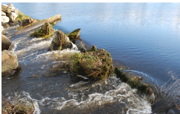
Figure 51 : Rampe en enrochement encombrée
