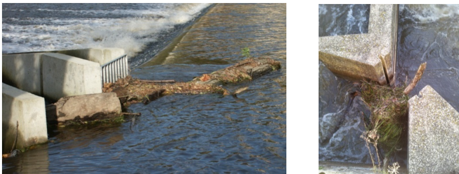
Figure 7 : Encombrement d'une entrée hydraulique (à gauche) et d'une échancrure interbassins (à droite)
