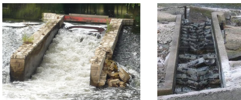
Figure 9 : Passes à ralentisseurs ayant subi une dégradation d'un muret (à gauche) et de ralentisseurs (à droite)
