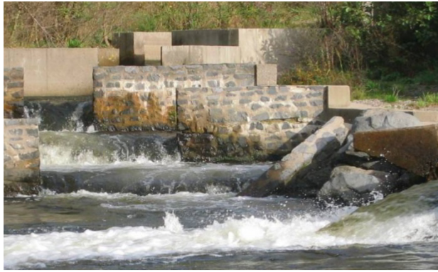
Figure 47 : Prébarrage dont un muret est écroulé
