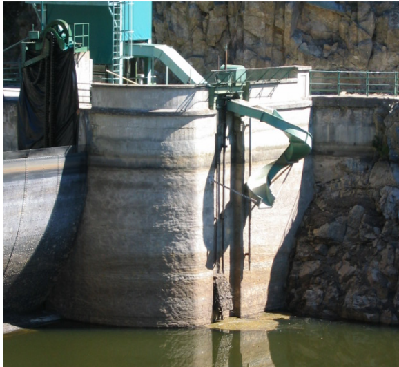
Figure 56 : Hauteur de chute au niveau de la sortie piscicole trop importante du fait de l'abaissement de la cote de la retenue
