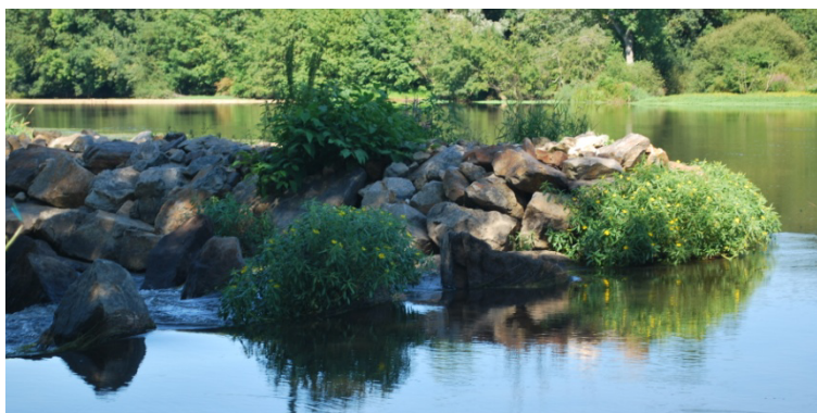
Figure 52 : Développement de la Jussie sur les blocs d'une rampe en enrochements
