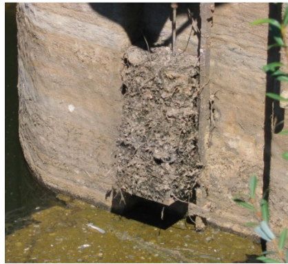
Figure 55 : Grille de protection de la prise d'eau du débit d'attrait d'un ascenseur à poissons colmatée
