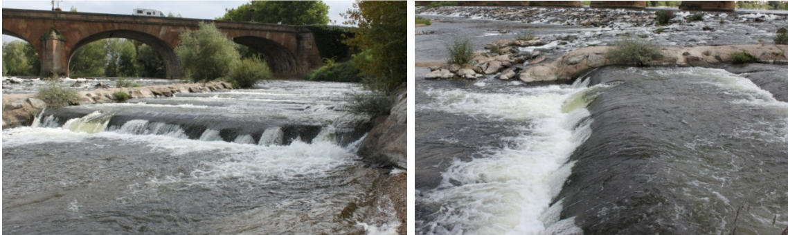
Figure 10 : Augmentation de la hauteur de la chute aval d'une rampe en enrochement liée à l'incision du cours d'eau
