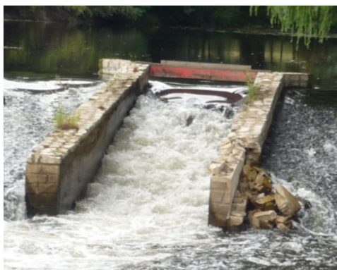
Figure 35 : Muret d'une passe à ralentisseurs partiellement écroulé
