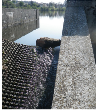
Figure 44 : Encombrement de l'entrée hydraulique d'une passe à anguille
