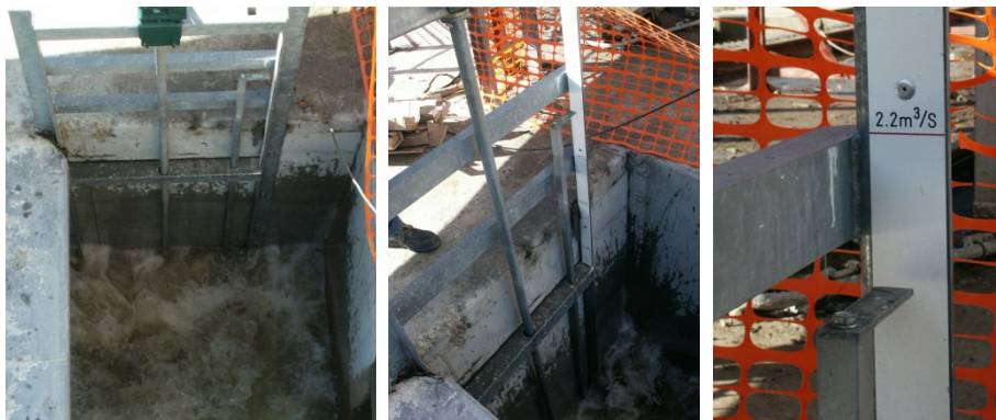
Figure 26 : Vanne de régulation du débit d'attrait complémentaire
