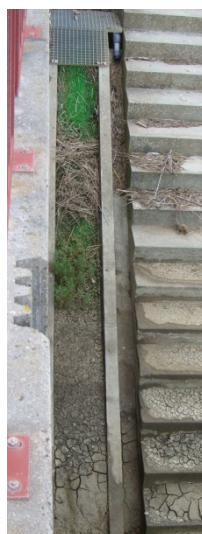
Figure 45 : Passe à anguilles en "tapis brosse" colmatée par des sédiments
