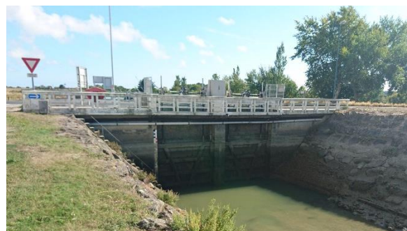
Figure 4 : Écluse du Pont Neuf à La Barre-de-Monts, vue depuis l'aval à marée basse. Photo : A. Chenal
