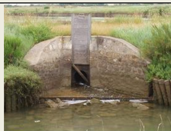
Prise de marais salé ( buse + glissière extérieure ) Moulin des Loges, Marennes (17) © Irstea
