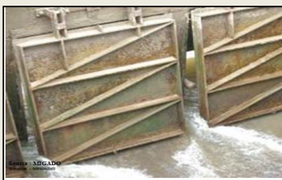
Clapets avec raidisseurs. Vue d'aval au jusant © Syndicat Centre Médoc et Migado
