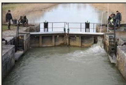
Admission d'eau par vantelle de surface obturable ( ouvrage de Biard, Charente-Maritime ) © CG 17 et Pôle Ecohydraulique
