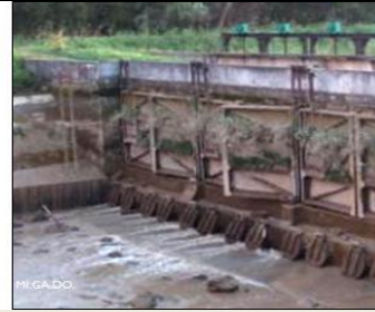
Série de portes à flot plus clapets de fond doublée d'une ligne de vannes murales © Migado
