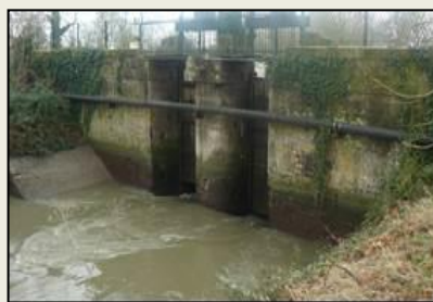
Admission d'eau par ouverture partielle par le fond ( ouvrage de Charras, Charente-Maritime ) © Unima-Pôle Ecohydraulique
