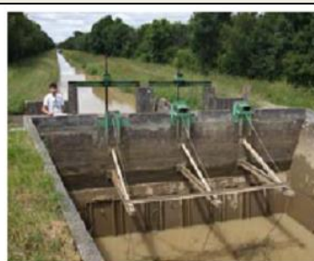
Ouvrage composite ( 2 vannes levantes + 3 clapets ) Chenal du Milieu-Saint Julien de Beycheville (Gironde) © Migado
