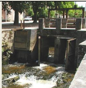
Ouvrage composite ( deux clapets en RD + 2 vannes mono-bloc amont + 2 portes à flot aval en RG ) Isle Saint Georges- Saucats (Gironde) © Irstea
