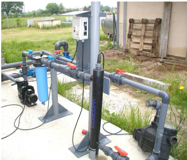
Système de filtration désinfection
